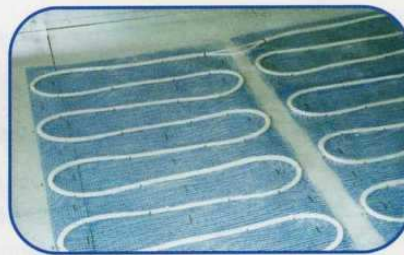
2. El montaje se realiza formando meandros, sin cortar el tubo , sino sólo la malla, poniendo especial cuidado en no dañar los tubos.
