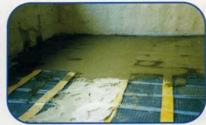
3. Fijar la malla texturizada con cola flexible (Flexkleber) al suelo. Seguidamente se realiza la compensación de nivel del suelo de 8 mm con masa flexible de nivelar (p.ej. CM 17 / CM 19 de Ceresit o productos de PCI).
